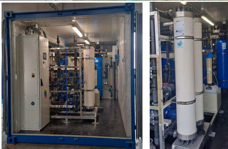
Obrázek 3: Úpravna povrchové vody v kontejneru
