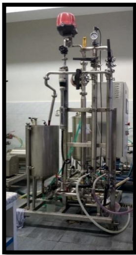
Obrázek 1: Filtrační jednotka TIA
