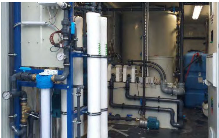
Obr. 5.5 - Pohled na jednotku reverzní osmózy, sedimentační reaktor a vzduchomembránové kalová čerpadla
