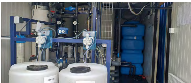
Obr. 5.4 - Pohled na ultrafiltrační jednotku
